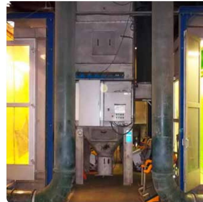
CO 2 NTRÖL Erfolgsbeispiel 3 Absaugstation in einer Pulverbeschichtungsanlage
